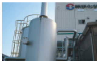
放爆槽（浜岡サイト）
