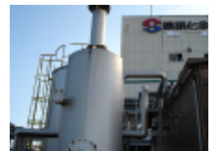
放爆槽（浜岡サイト）
