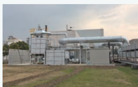
排気ガス処理設備
