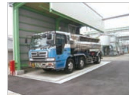
ローリー充填場 2010年設置。充填作業時の安全性向上(漏洩事故防止)及び、充填時の車上からの転落防止を施しています。
