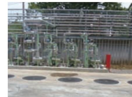
地下タンク 屋外に設置していたタンク貯蔵設備を地下に移設し、火災に対する安全性を高めました。
