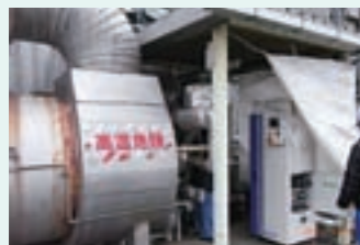
テスト機の設置
