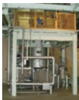
浜岡サイト 自動溶剤回収装置
