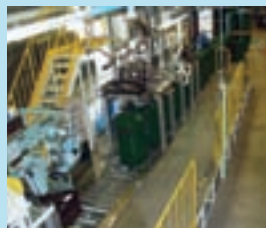
▲B棟自動充填機
