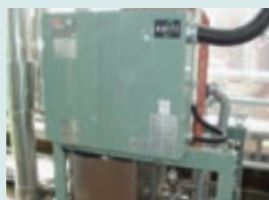
チラー（冷水製造装置）
