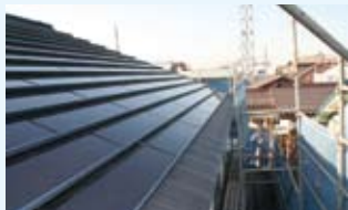
屋根に取り付けた太陽電池パネル
