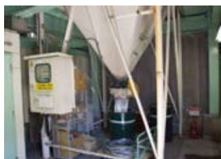
粉体集塵機防音壁 内観
