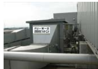
活性炭吸着設備
